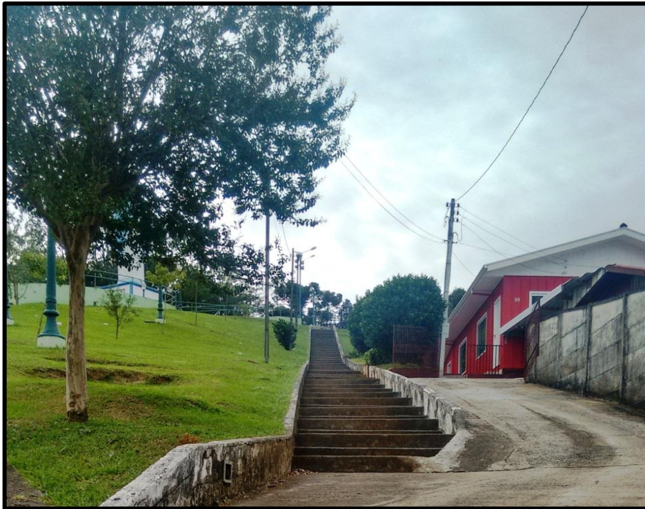
Imagem 17: Escada de acesso sem corrimão Fonte: Acervo do autor, 2016.
