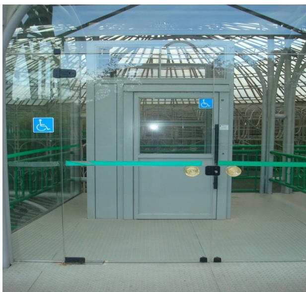
Figura 17 – elevador exclusivo para cadeirantes e pessoas com problemas de locomoção. Fonte: fotos da autora deste trabalho.
