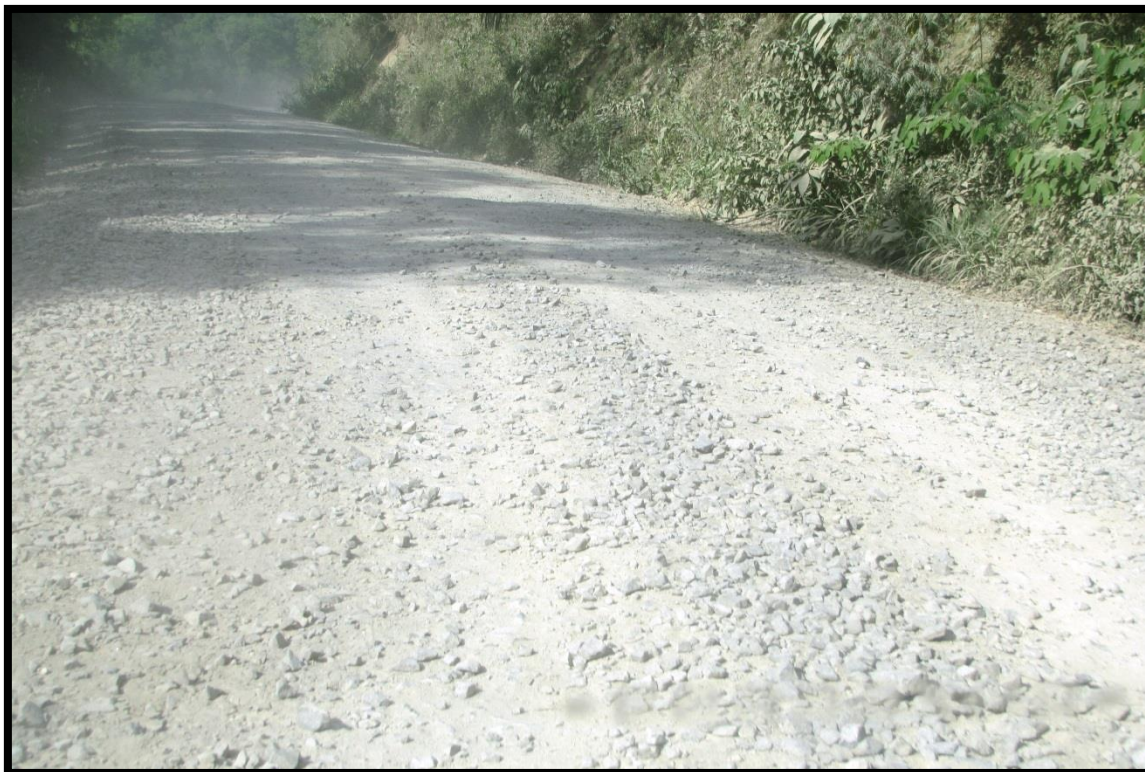
Figura 6 – ocorrência de pedras Fonte: Acervo do autor
