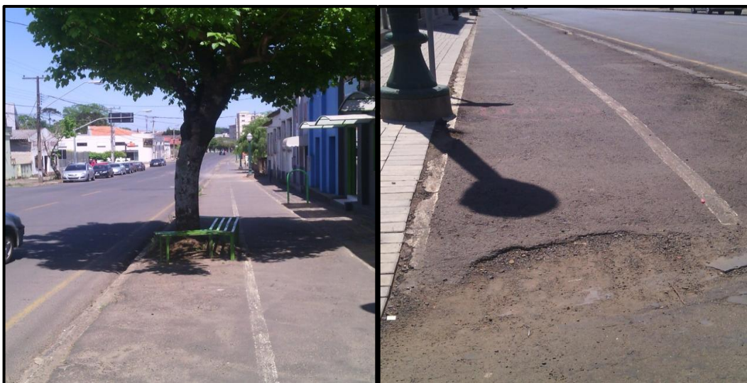
Figura 10 - Trecho 01 e 02 – Bloqueios nas vias e degradação
