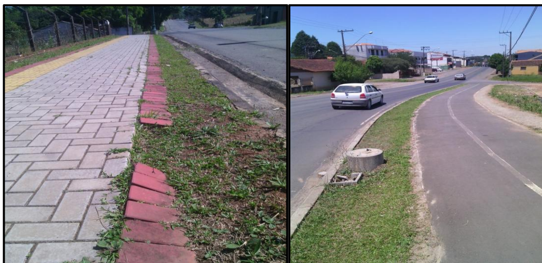
Figura 6 - Desnível de pista - Trecho 02/03
