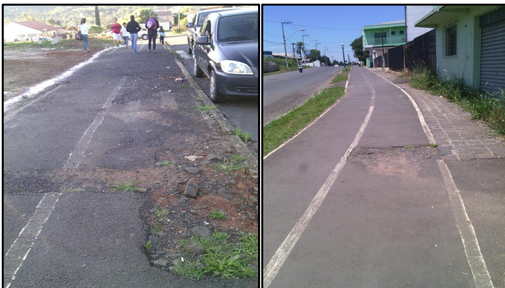
Figura 18 - Trecho 02 Piso degradado
