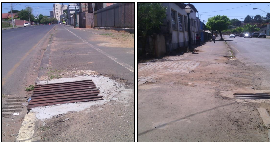
Figura 19 - Trecho 02 Instalação inadequada de boca de lobo.
