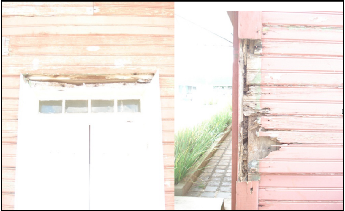
Figura 14: Estado atual da Casa da Cultura, em 2016. Fonte: Repositório digital da Casa da Cultura. 18
